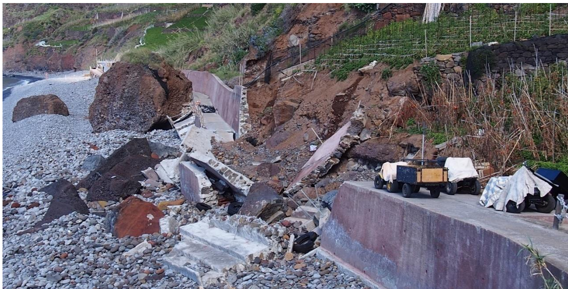
Figura 16 - Destruição das Infraestruturas de acesso e produção agrícola, Fajãs Cabo Girão. Fonte. © Associação Insular de Geografia.
