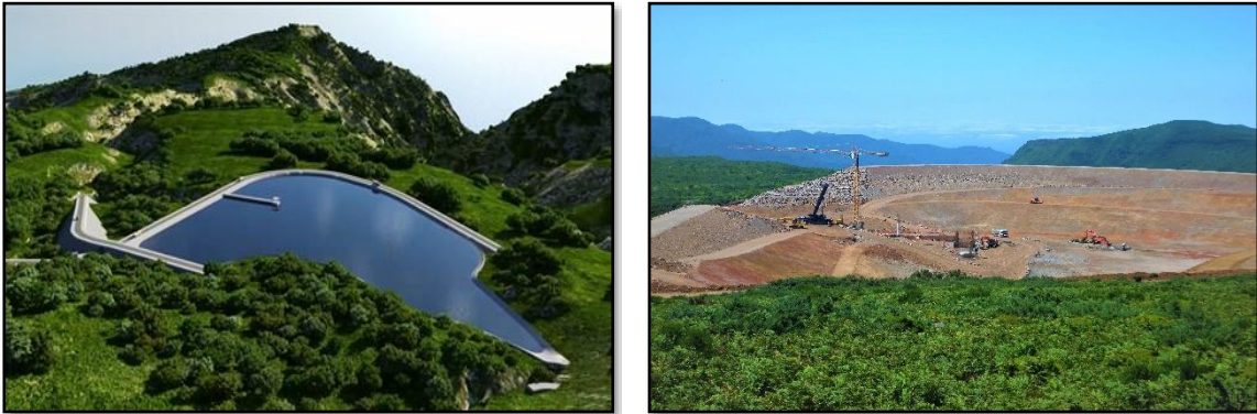
Figura 18 – Maquete (Fonte: EEM) e obras do Projeto de Ampliação do Aproveitamento Hidroelétrico da Calheta no PF do Paul da Serra.
